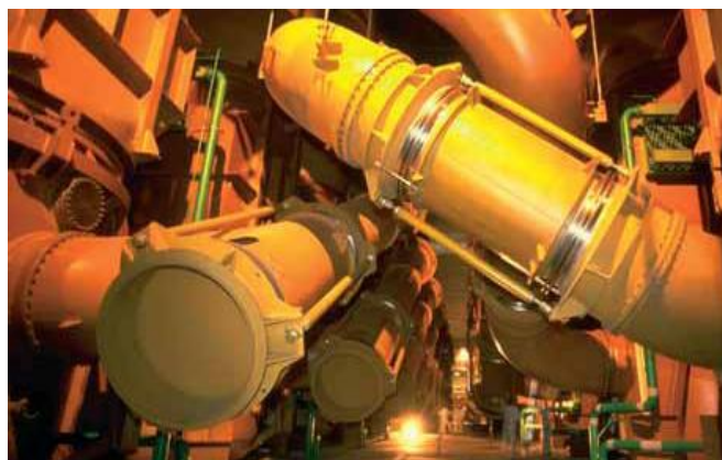
Caisson abritant les compresseurs
