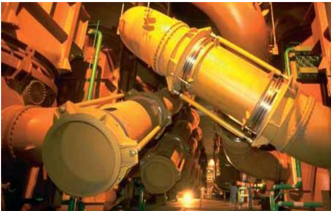
Caisson abritant les compresseurs
