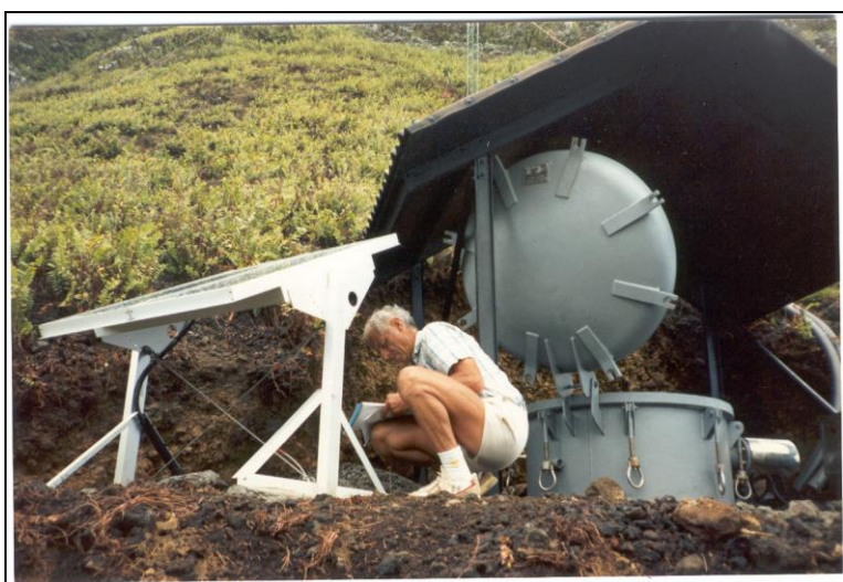
Stations sismiques et relais de transmission de signaux sismiques installés respectivement :
