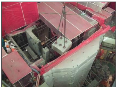
4. Découpe de la face avant du bloc piscine avec des scies à câbles
