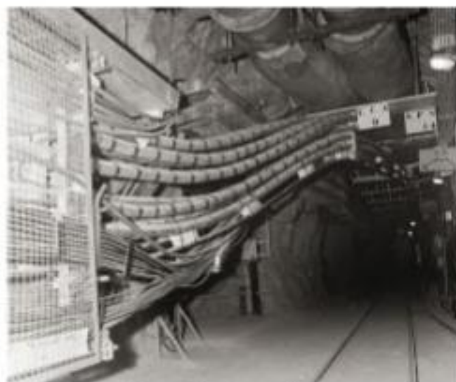
Installation à l'intérieur d'une galerie.
